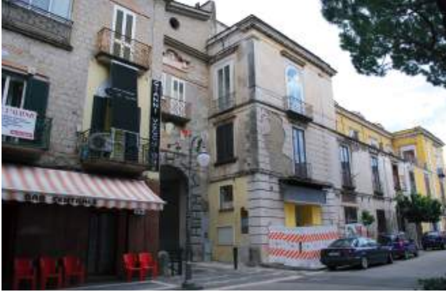
Fig. 16. Cicciano, scorcio da ovest del prospetto meridionale. È evidente l'aggiunzione ottocentesca emergente rispetto all'ingresso originario.
